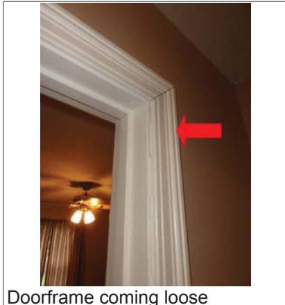
Doorframe coming loose
